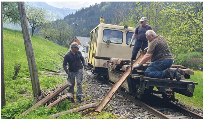
Am 19. Mai 2023 werden die Stahlschwellen im Baustellenbereich beim Gasthof Zur Paula ausgelegt. Foto: Ingo Wiener
