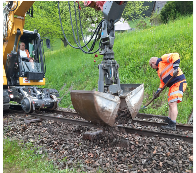
Einzelschwellentausch durch die Firma Swietelsky beim Gasthof Zur Paula am 24. Mai 2023. Foto: Ingo Wiener
