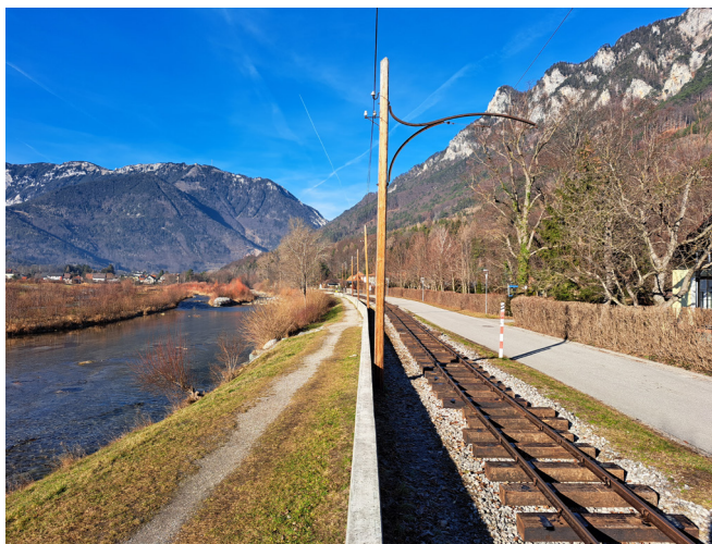
Am 8. Jänner liegen bereits wieder beide Schienen auf den Schwellen und am Gleis sind die Baufortschritte am Ende des fast frühlinghaften Tages deutlich erkennbar. Foto: Ferdinand Drexler
