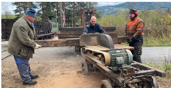
Am 7. November werden in Hirschwang die Schwellen für die Gleisbaustelle zwischen km 3,1 und 3,3 von Erich, Reinhard und Albin geschnitten. Foto: Florian Strobl
