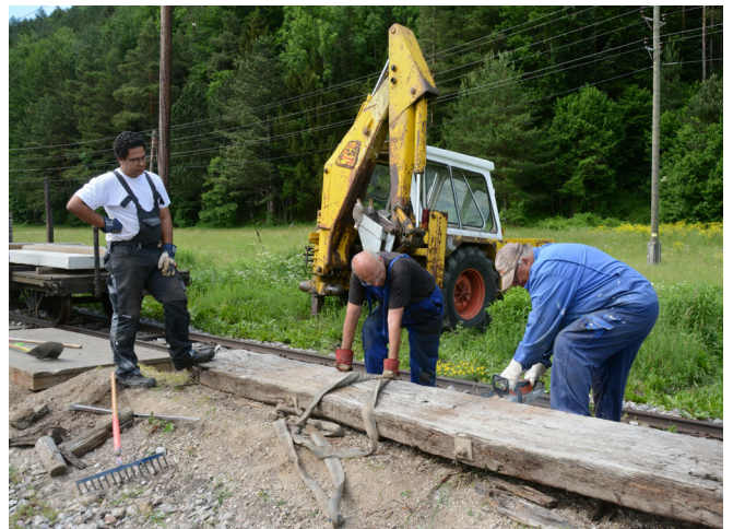
Die Holzschwellen, die bisher als Bahnsteigkante gedient haben, werden mithilfe unseres Baggers von Albin (nicht im Bild), Florian (unser Baggerfahrer), Luca, Walter und Erich ausgebaut und anschließend abtransportiert. Foto: Albin Michlmayr
