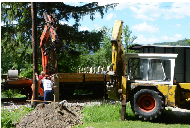
Bei der Haltestelle Haaberg werden am 6. Juni ein neuer Betonfuß und ein neuer Fahrleitungsmast gesetzt. Kranwagen und Bagger ermöglichen zusammen mit ihren routinierten Maschinisten eine effiziente Durchführung. Foto: Albin Michlmayr
