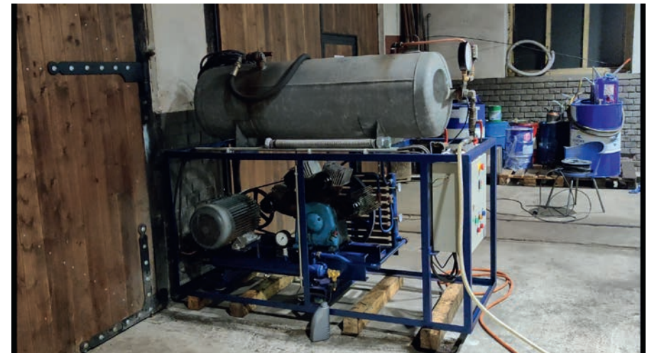
Die neue Kompressoranlage im Heizhaus Kienberg. Foto: Thomas Edlinger
