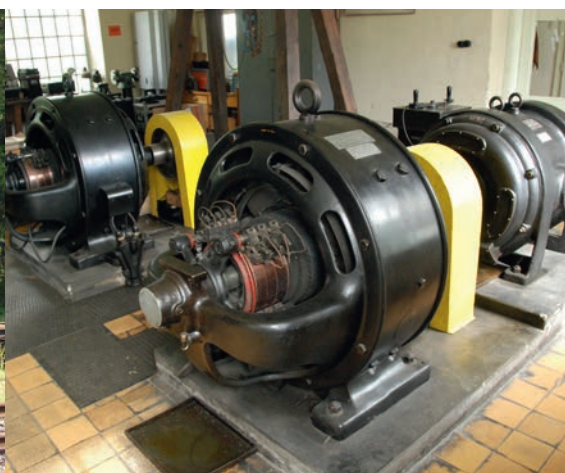
Nach wie vor beeindruckend ist die historische Umformeranlage in Reichenau. Foto: Albin Michlmayr, 15. 08. 2010
