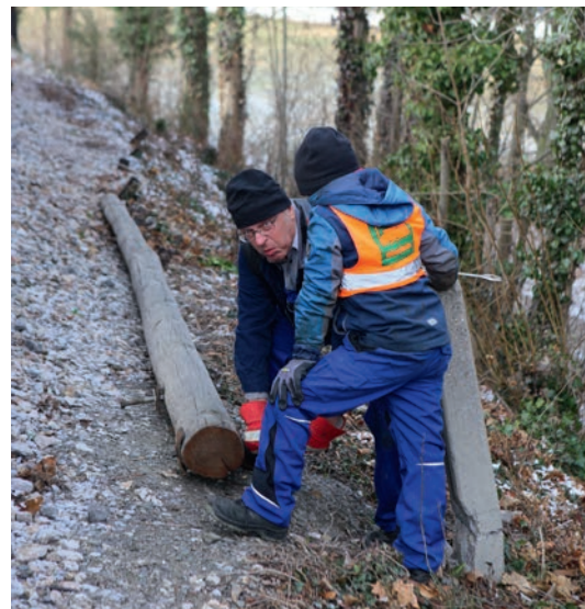
Walter und Emil beim Ablegen des demontierten Oberleitungsmasten. Auf dem Bild ist der beschädigte Beton-Fuß gut erkennbar. Foto: Albert Malli
