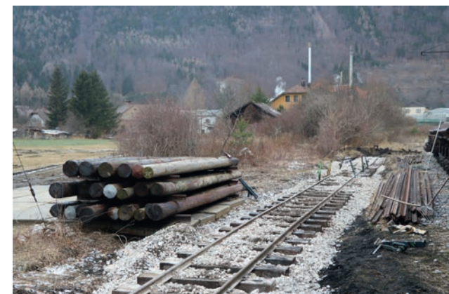
Das neue Abstellgleis ist bereits zum Teil gestopft und ausgerichtet. Links hinter den Fahrleitungsmasten kann man noch die Trasse des alten Personenzug-Gleises zum ehemaligen Bahnhof Hirschwang erkennen. Foto: Ferdinand Drexler
