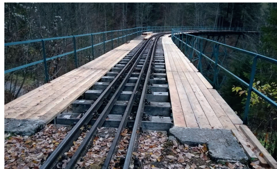
Der Austausch der Bedielung der Hühnernest-Brücke ist fast abgeschlossen. Foto: Jack Riegler
