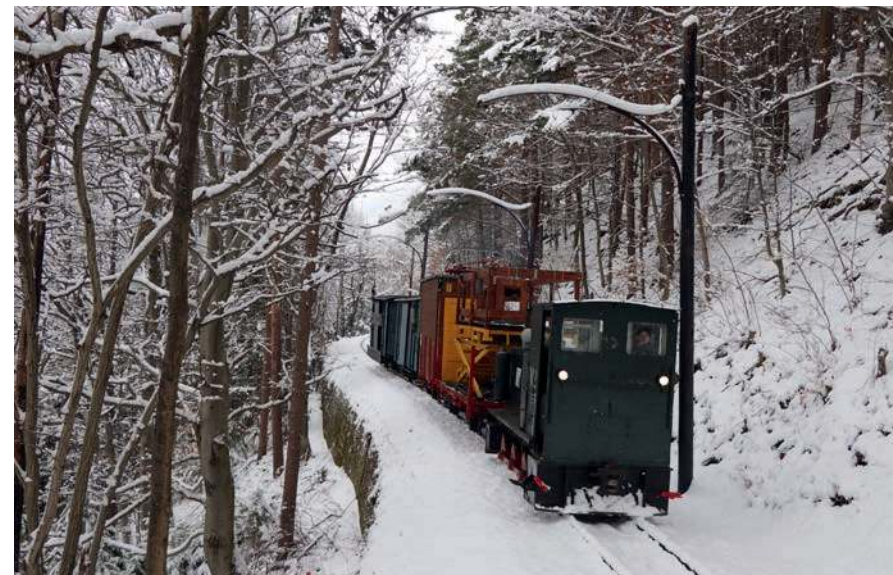
Am 20. März zieht die Lok V2 einen Fahrleitungs-Arbeitszug den tiefverschneiten Artzberg hinauf.
