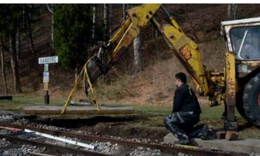
Nacheinander werden die Betonplatten in der Haltestelle Haaberg in Position gebracht. Foto: Albin Michlmayr
