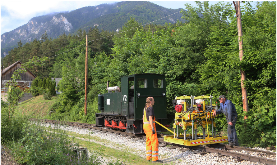
Einsatz der Gleisstopfmaschine im Steinhofgraben. Hier wurden 24 Schwellen erneuert. Foto: Albert Malli
