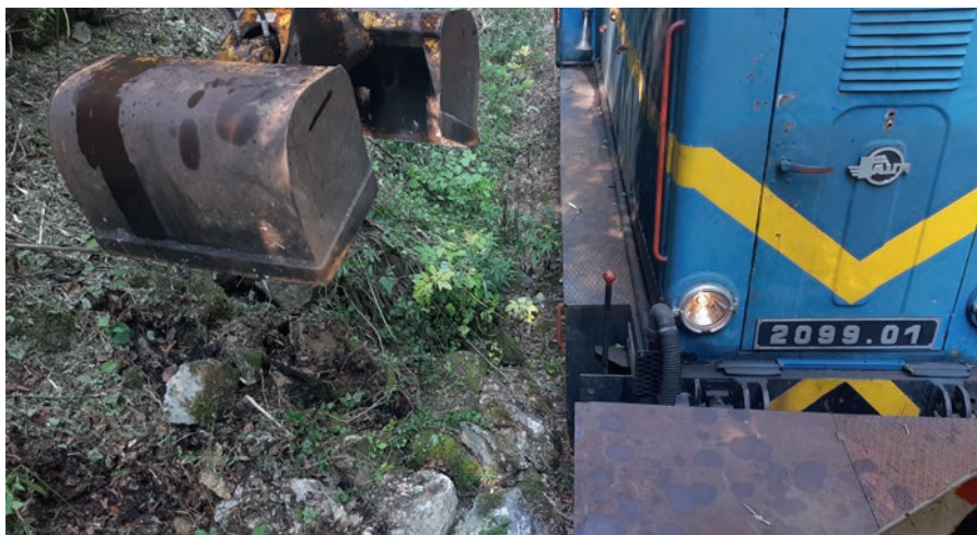
Baggerarbeiten mit dem BEW I und der 2099.01 im August 2020. Foto: Stephan Rewitzer
