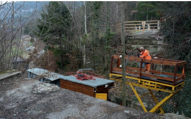
Reinhard Popp montiert am 13.12. 2020 den Ausleger am neuen Mast im Steinhofgraben an der Stelle der abgetragenen gleichnamigen Brücke.
