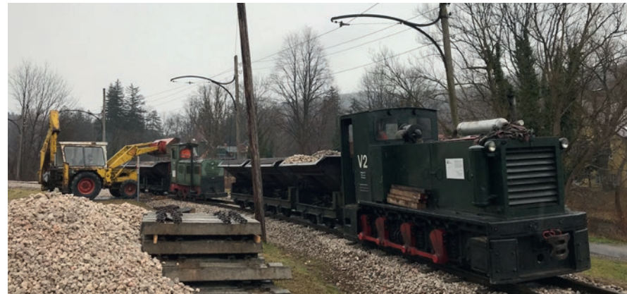
Hochbetrieb im Bahnhof Reichenau am 30. 12. 2020 beim Beladen der beiden Züge zum Einschottern der Gleisbaustelle zwischen der Weiche I des Bhf. Reichenau und der Kurhausbrücke.
