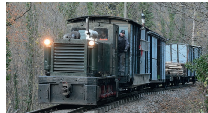
Am Ende der Gleisbauwoche befährt der Bauzug in Schrittgeschwindigkeit den neuen Abschnitt bei dem noch der Gleisschotter ausgebracht werden muss. Foto: Albin Michlmayr
