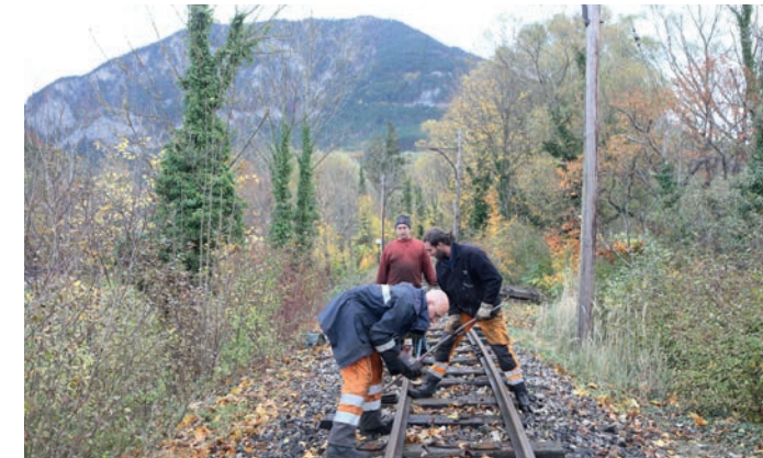
Die alten Schienennägel und -schrauben werden von den Holzschwellen gelöst und geordnet für einen möglichen späteren Einbau gesammelt. Foto: Albert Malli
